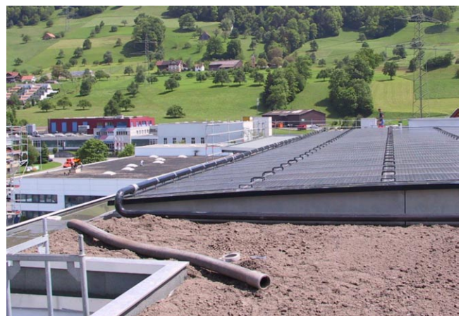
Captteurs solaires sur le toit d'un bâtiment du Centre D4.
